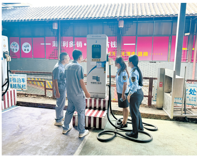
△普洱市、区两级市场监管部门联合市检验检测院开展充电桩检查。
